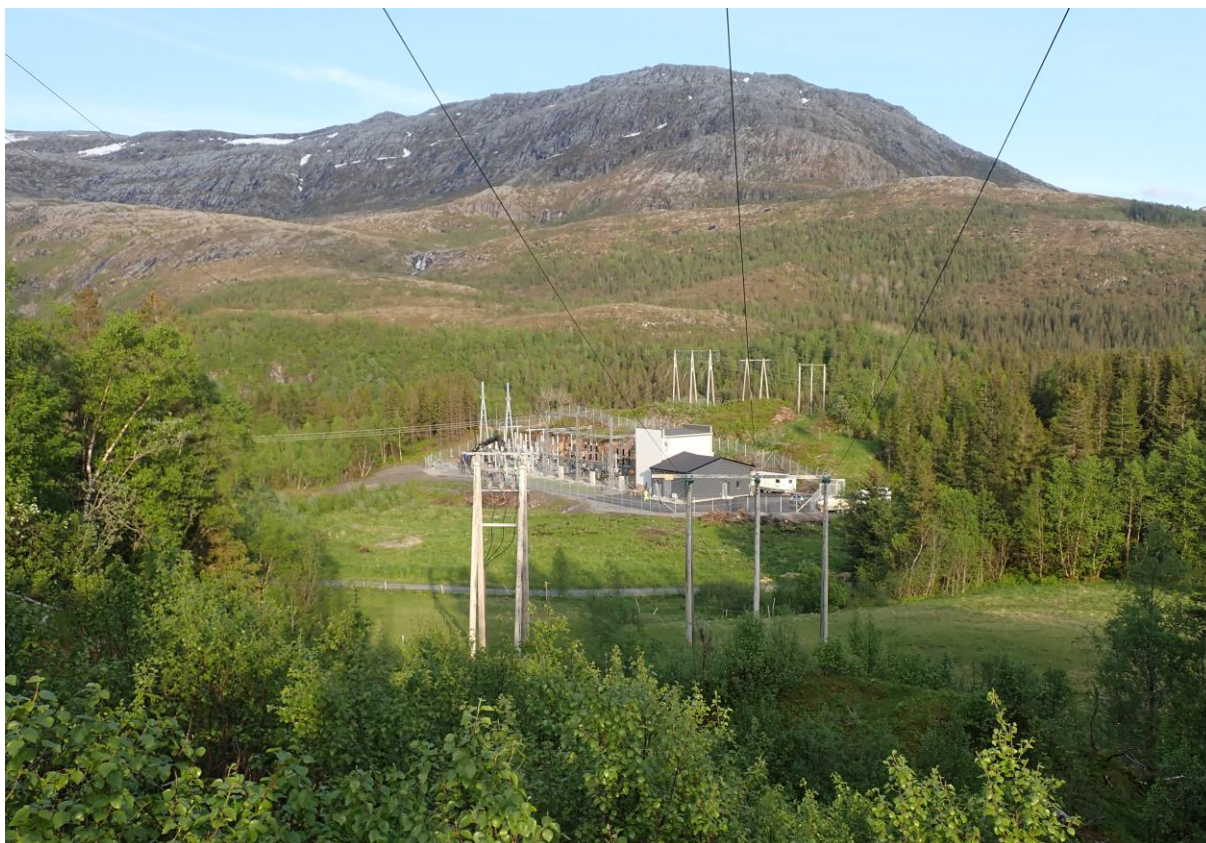
Figur 3.5. Tilkoplingspunktet for 132 kV ledningen ved Leiren.
